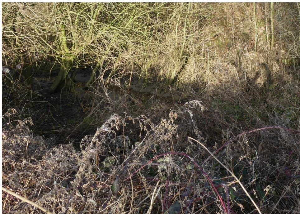
Illustration 25 : Point d'eau situé en point bas entre les deux talus au sud de la RN42 et de l'ouvrage 62-1813. (Source : ©A-C De Rouck / Cerema HdF).
