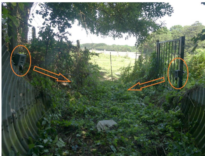
Illustration 27 : Pièges posés en vis-à-vis au nord de l'ouvrage 62-1827. (Source : © A.-C. De Rouck / Cerema HdF)
