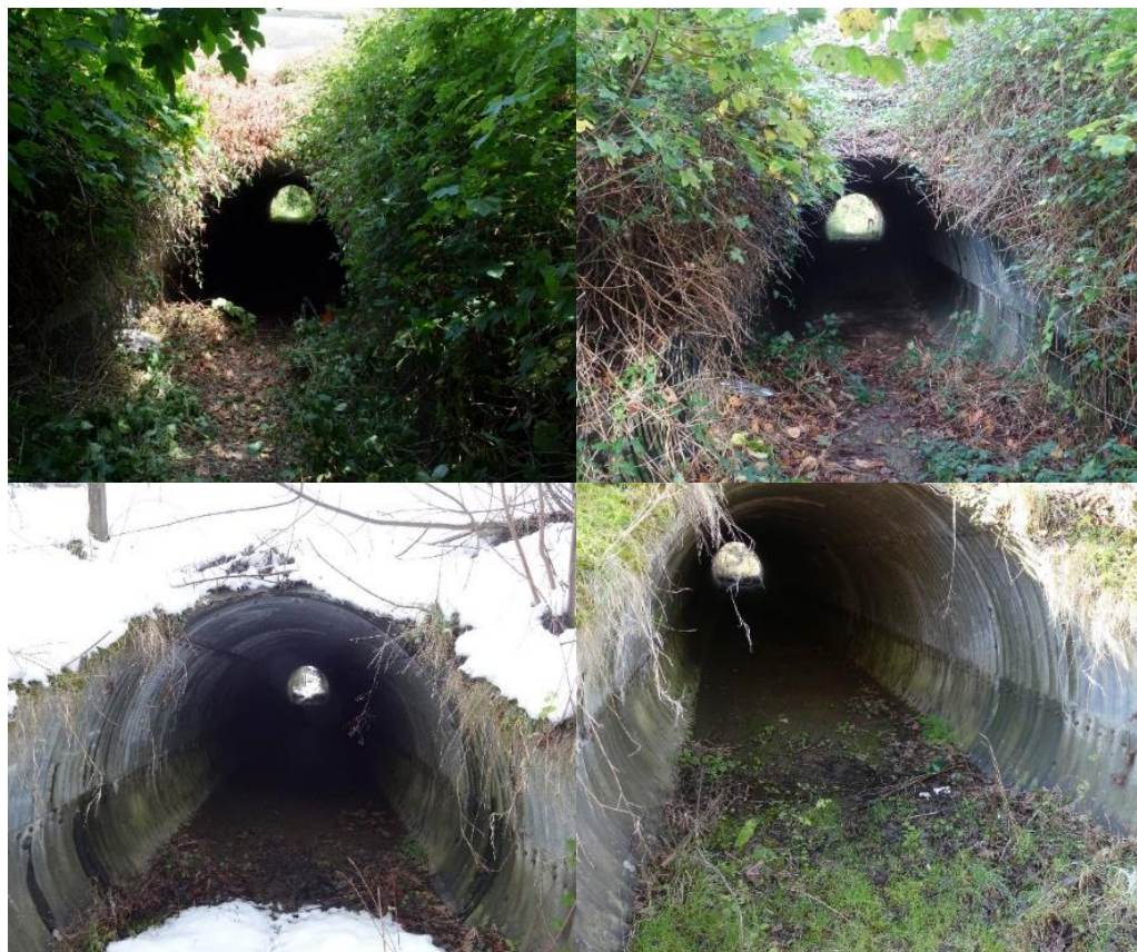
Illustration 23 : Evolution de la co-visibilité d'une extrémité à l'autre de l'ouvrage 62-1813 au cours des saisons. (Sources : cc-by-sa-3 O. Pichard, ©A-C De Rouck / Cerema HdF & ©F Fournier / Cerema HdF).
