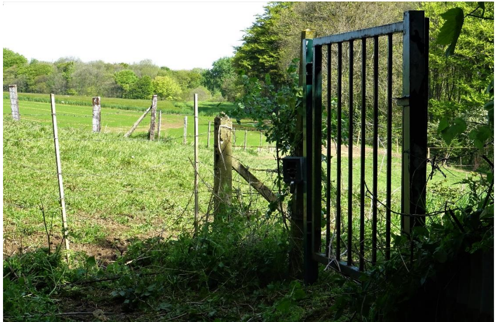
Illustration 17 : Clôture à environ 4m devant l'ouverture nord de l'ouvrage 62-1827 et sur les bords du talus. (Source : ©A.-C. De Rouck / Cerema HdF).
