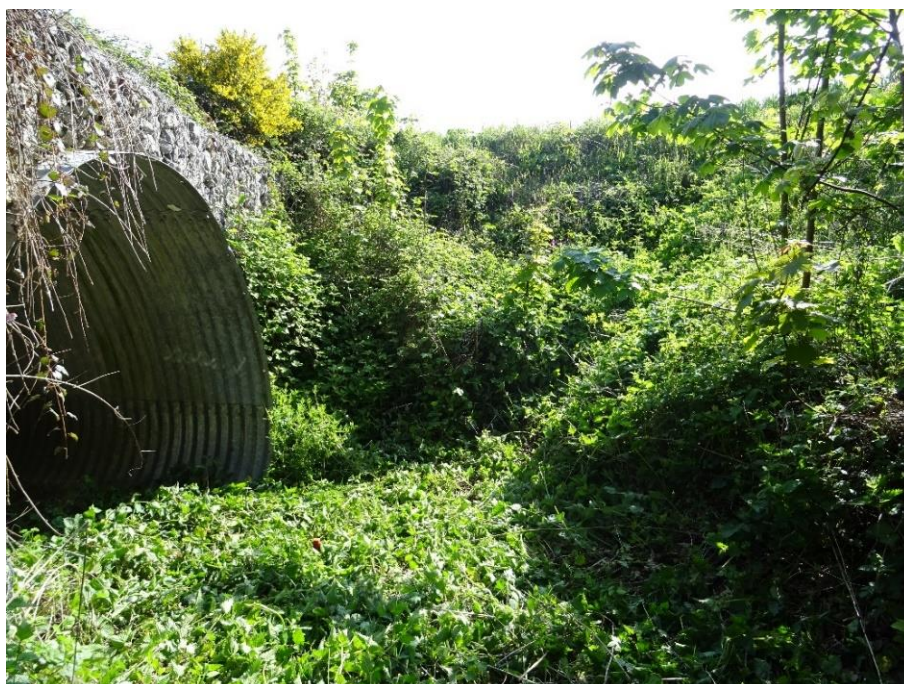
Illustration 22 : Orties devant l'entrée sud de l'ouvrage 62-1827 et ronces sur le talus d'accès
