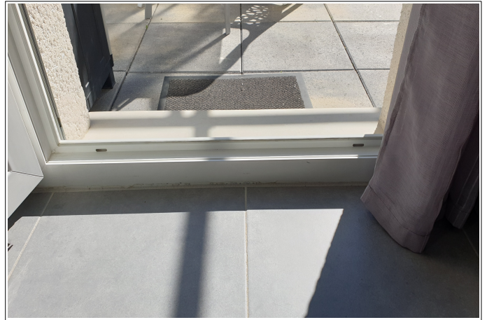
terrasse inaccessible compte tenu du ressaut trop important depuis l'intérieur
