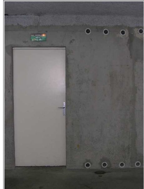
absence de signalisation d'une issue de secours, absence des plans et consignes d'évacuation dans un parc de stationnement
