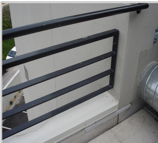
garde corps avec "effet échelle" permettant l'escalade et un risque de chute
