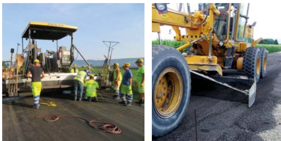
Figure 3 / ORRAP Suisse & France - Mise en œuvre avec un finisseur/une niveleuse Source Empa & Cerema
