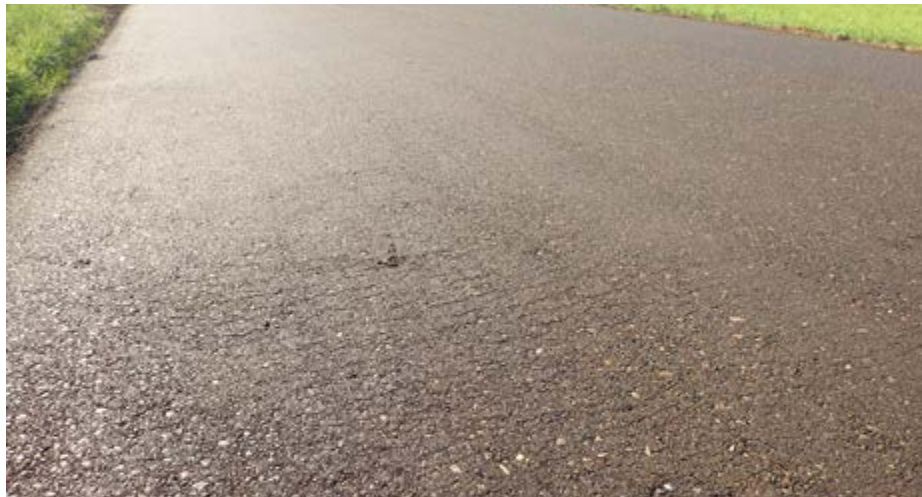
Figure 5 / ORRAP Suisse - Des vibrations peuvent générer des fissures Source Cerema
