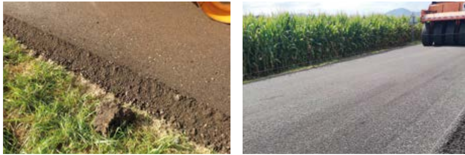
Figure 6 / ORRAP Suisse & France - Compactage difficile sur les rives de chaussée Source Cerema
