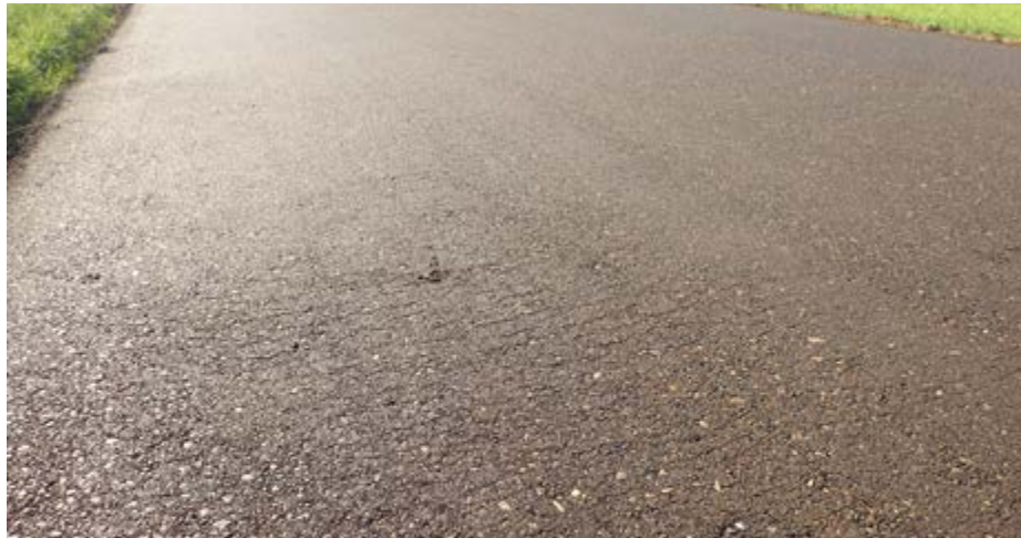
Abbildung 5/ ORRAP Schweiz - Rissbildung durch Vibration. Quelle: Cerema
