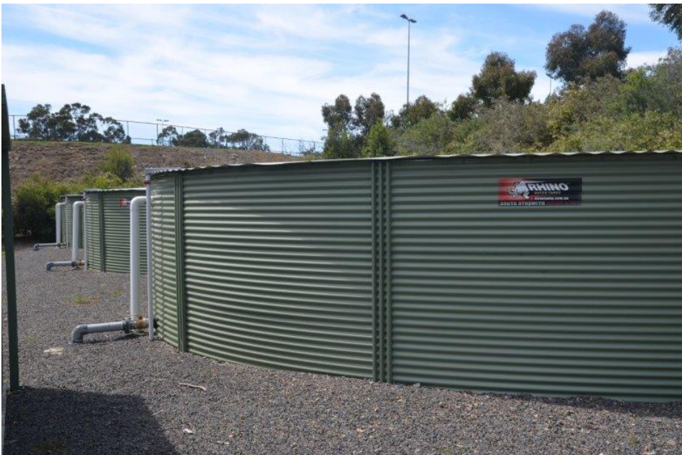
Illustration 55 : D'énormes citernes permettent le stockage et la réutilisation de l'eau pluviale pour un établissement scolaire de Lilydale. Crédit : Cerema.
