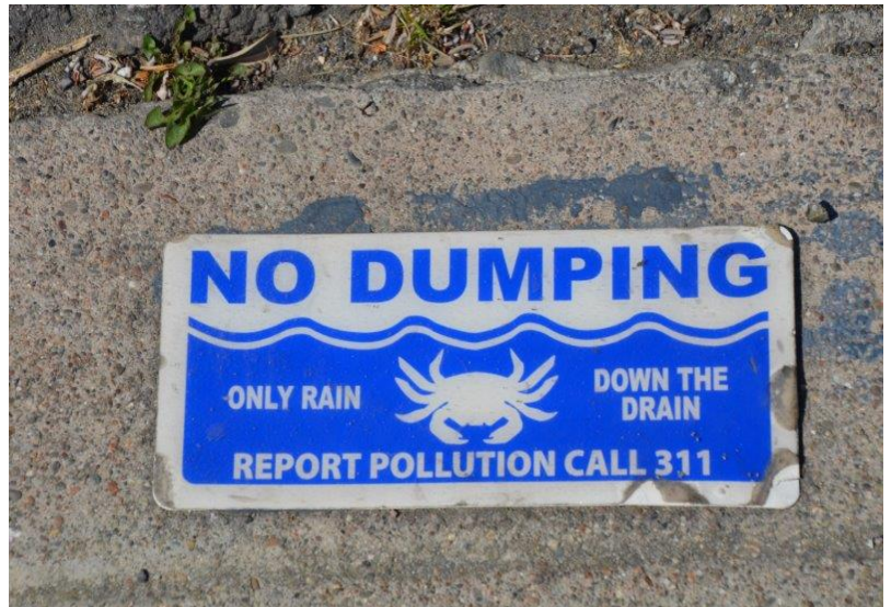
Illustration 34 : Détail de la signalétique fixée à côté des avaloirs : "No dumping, only rain down the drain" que l'on peut traduire par "ne rien jeter, seulement de la pluie dans les égouts". Un numéro de téléphone dédié est proposé en cas de problème constaté.
