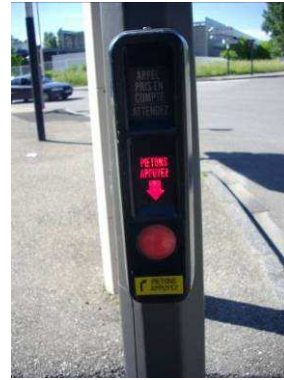
Photo 2.9 Exemple de bouton-poussoir, à Vaulx-en-Velin
