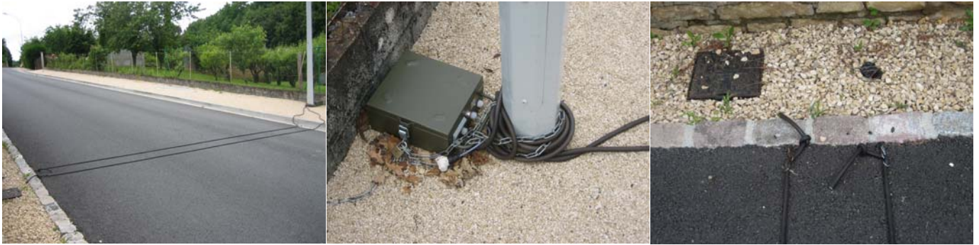
Figure 7 : Mise en place du compteur MIXTRA pendant les mesures « avant »
