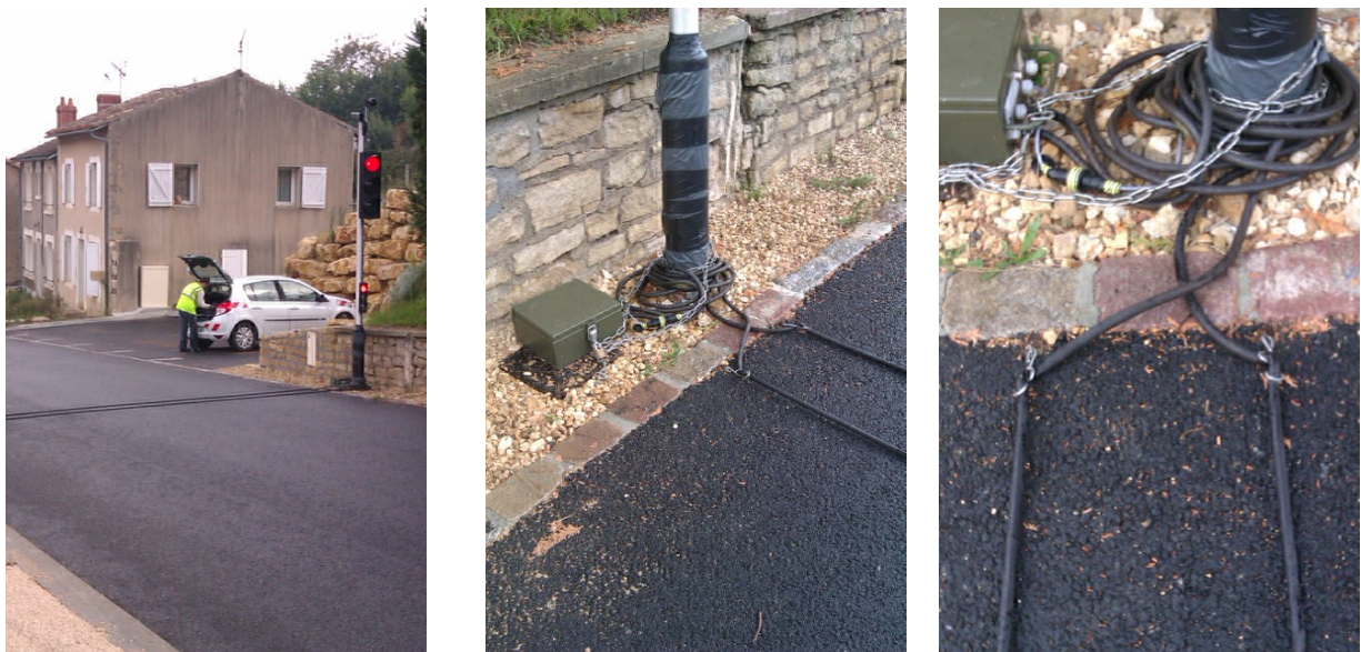
Figure 8 : Mise en place du compteur MIXTRA pendant les mesures « après »
