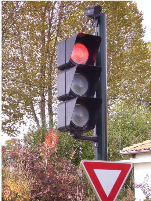
Feu et détecteur radar – rue V. Auriol
