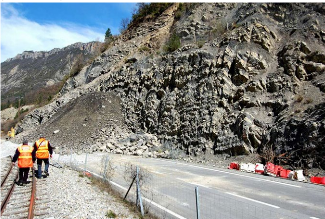
Éboulement sur la RN 85 (Chaudon-Norante)
