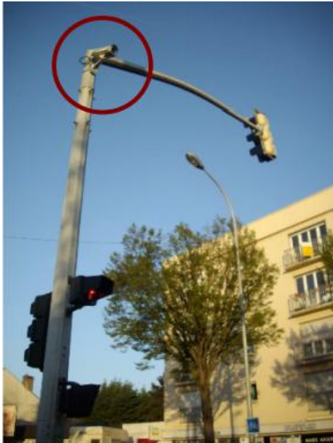
La caméra est installée sur une potence
