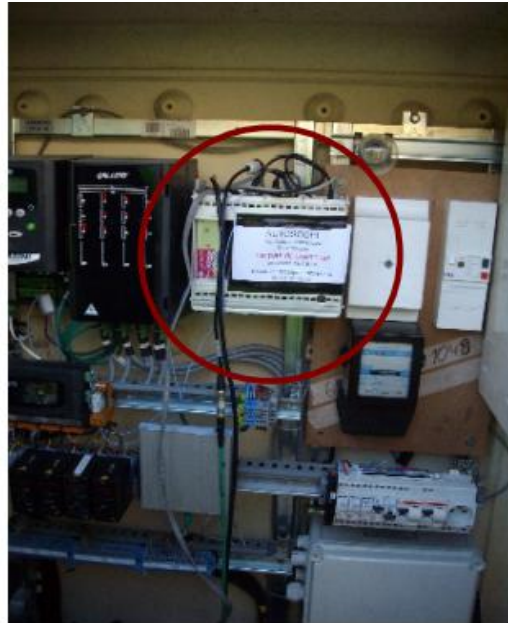
L'autoscope est installé dans une armoire
