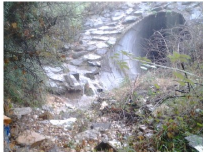
Buse PR289+200 13/10/2016 14h10 (amont: aucun écoulement d'eau dans le lit du ruisseau; écoulement d'eau en provenance de l'A75; infiltration sous la buse).
