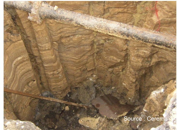
Cavité de dissolution sous une canalisation (Butte de Cormeil, 95)
