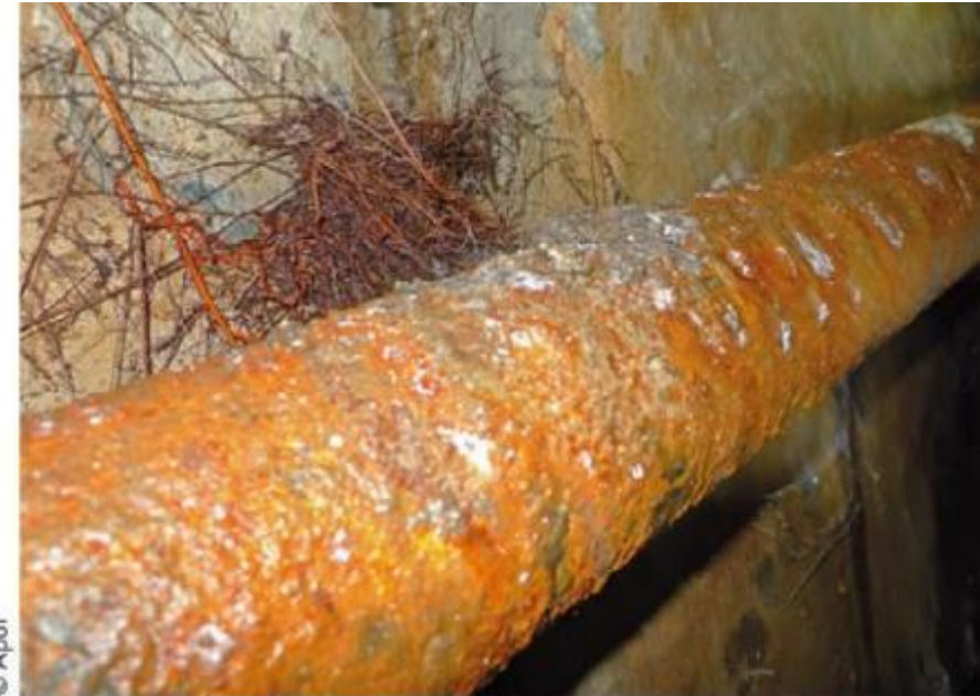
Racines dans les égouts, quartier de l'Observatoire, Paris 14e
