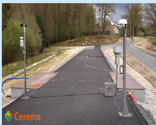
Vue de la piste du démonstrateur avec ses dispositifs météorologiques de surveillance
