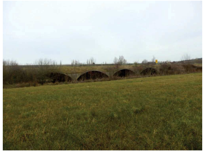
Illustration 9: Tunnels hydrauliques sous l'A16 à Isques
