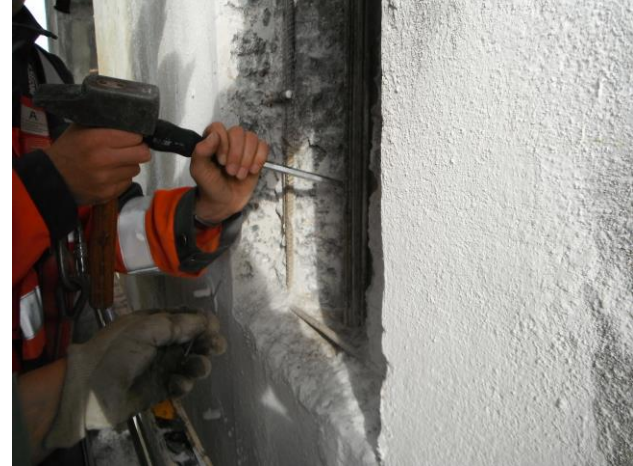
Décollement d'un fil à tester
