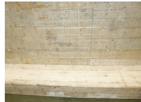
Fissures le long des aciers
