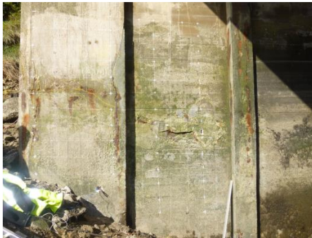
Fissures le long des aciers Traces d'oxydation
