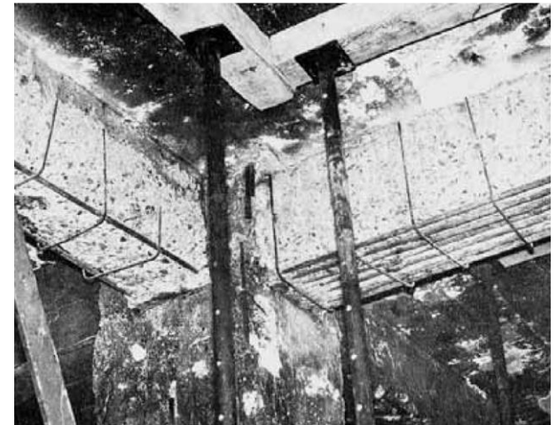
Eclatement du béton laissant apparaître les armatures
