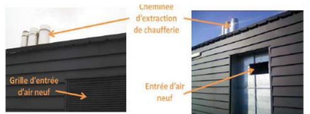
Entrees d'air en a proximite d'une source de pollution (Source: Cofely)
