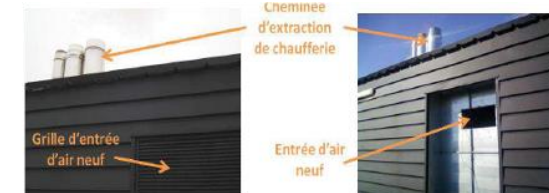
Entrées d'air en a proximité d'une source de pollution (Source: Cofely)
