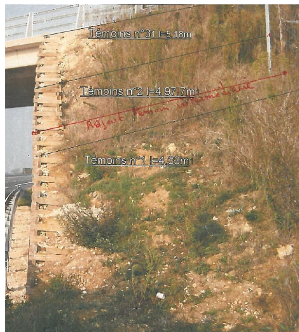
Variation entre témoins de la déformation du mur en aile droite de la culée
