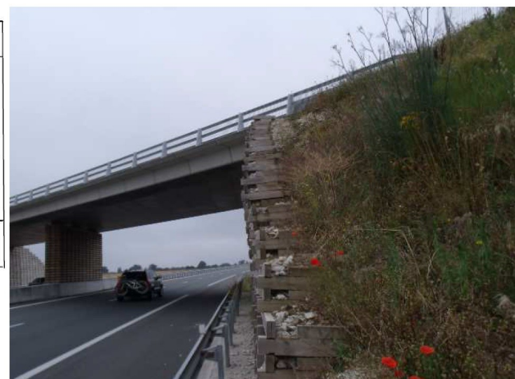
défaut 149 déversement du mur en aile droite de cn de 26cm
