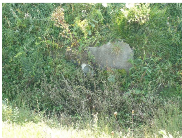
Figure 27: Débouché d'un collecteur de drains dans la rigole de Corbeville
