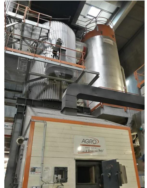
Chaudière bois du réseau de Roubaix
