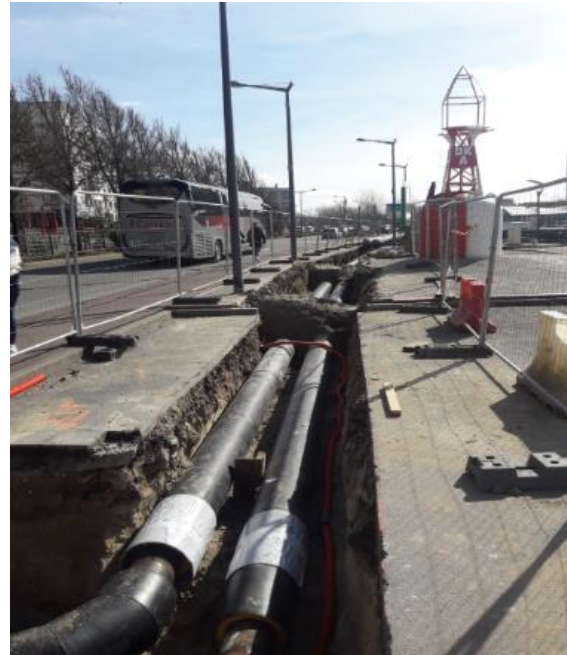
Canalisation enterrées du réseau de Boulogne-sur-Mer
