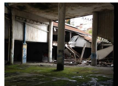
Effondrement toiture Novembre 2016
