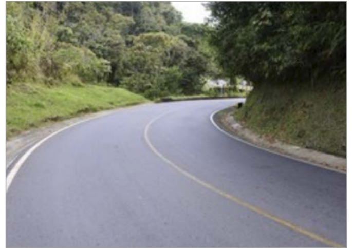
Dudosa adherencia de la calzada
