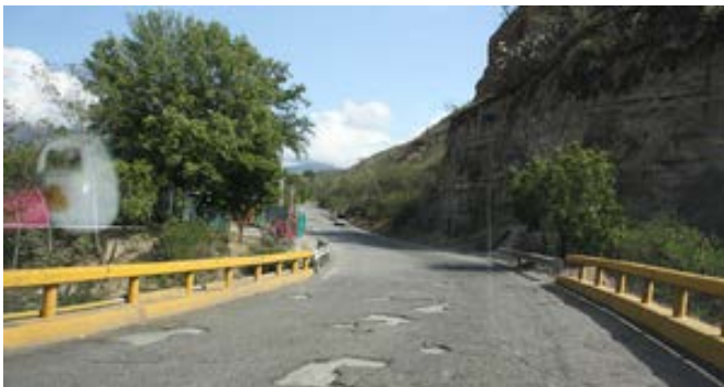
Baches en la calzada
