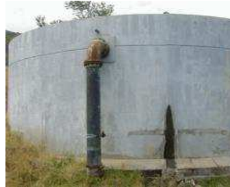
Fuites d'eau d'un réservoir
