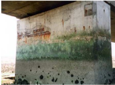
Piles soumises aux chlorures
