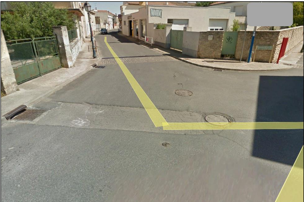
Figure 3.2.b : Accumulation de 10 événements au niveau d'une tranchée affaissée et de 2 bouches d'égout
