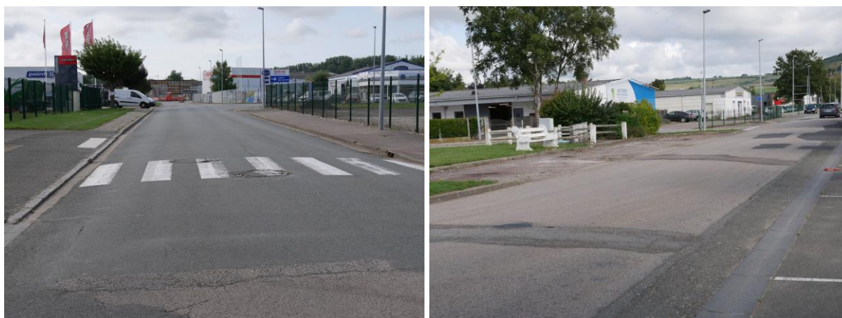
Figure 29 : incidents et évènements (état de chaussée, Neufchâtel en Bray)
