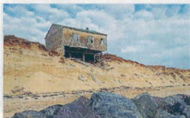
Cette photo d'une maison à Saint-Germain-sur-Ay qui menace de s'effondrer, traduit bien ce qu'il se passe l'avancée de la mer sur la terre ces dernières années.
