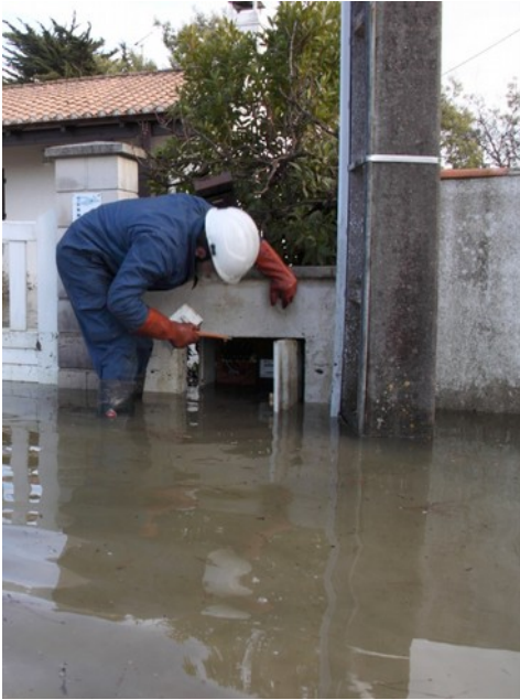
Scrutation d'un coffret de branchement
