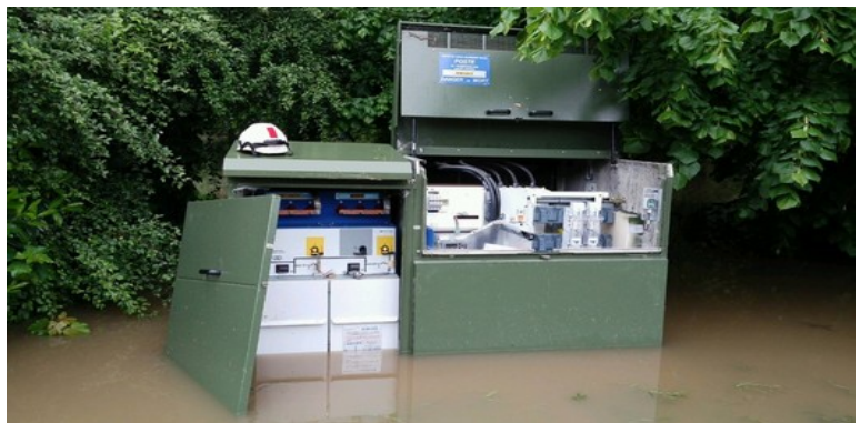
Poste d'électricité en zone inondée
