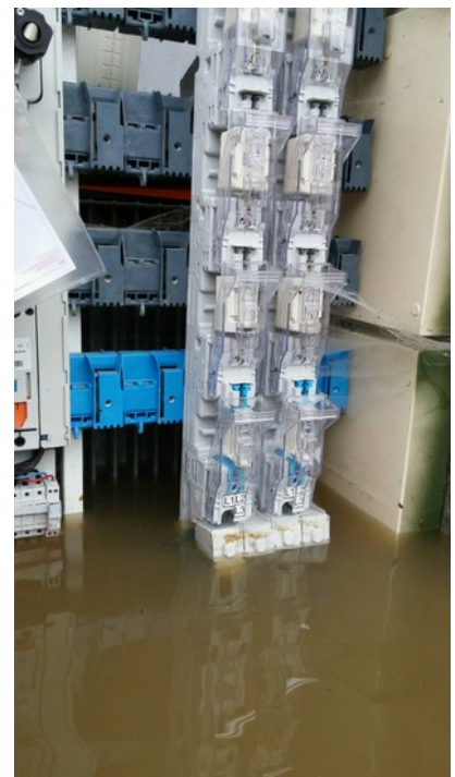
Distributeur basse tension inondé
