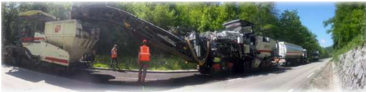
Atelier de retraitement en place ARM 2500 (Source Eiffage Infrastructures) lors d'un chantier sur une route départementale française.
