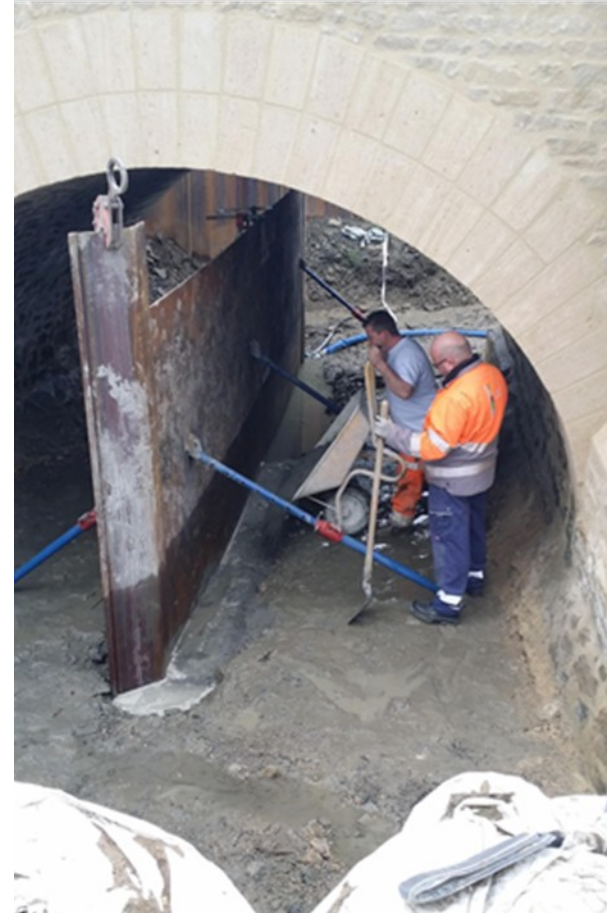
Préparation et mise en place, sous l'arche 3, d'une partie du batardeau de la phase 2
