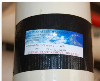
Conduites marquées à l'amiante. Source: UEPG
