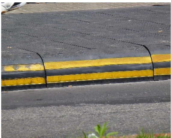
Bordure extérieure de protection à haute visibilité
