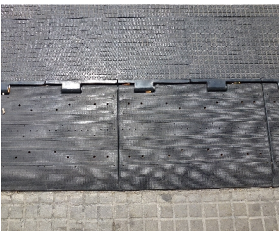
Grilles mobiles de mise à niveau avec le trottoir
