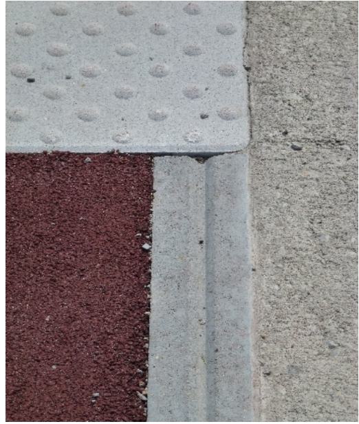
Arrêt « classique » : Signal aux entrées et sortie du bus + guide canne
