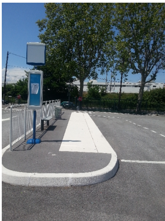
Quai aménagé dans le cadre de la création d'une gare routière « provisoire » pour un service de cars gérés par une société privée. Si la liaison quai-véhicule semble accessible, il n'y a aucune continuité de cheminement, la PMR ne pouvant même pas monter ou descendre du quai... La justification de l'emploi du dispositif est ici liée à la durée de vie a priori réduite de cet aménagement, puisque les créations d'une nouvelle gare routière et d'un pôle multi-modal sont prévues à relativement court terme (dans le cadre d'un grand projet de réaménagement urbain lié à la création du nouveau stade et l'aménagement de la ligne 2 du tramway).
