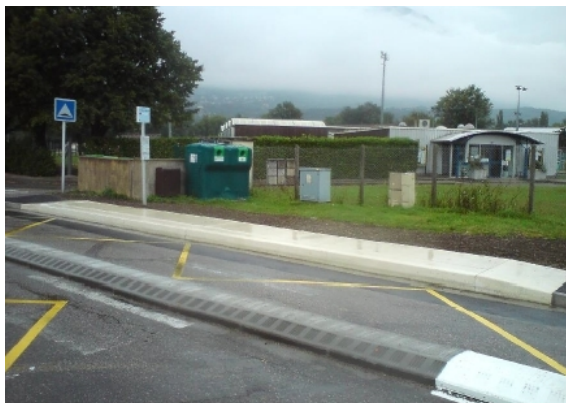
Après aménagement : pas de trottoir le long de l'avenue qui doit faire l'objet d'un réaménagement à moyen terme
