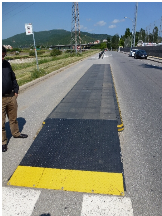
Implantation du quai de bus modulaire
