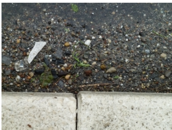
Mise en œuvre : décalage horizontale de 5 mm au moins, pouvant entraîner une usure potentielle des pneus
