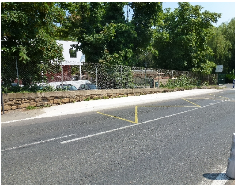
Quai en alignement, en milieu péri-urbain sur le territoire communal de Saint Cyr au Mont d'Or. Il s'agit d'un quai aménagé en ligne. Le quai mesure 18 m de longueur, 1,50 m de largeur avec 2 rampes. Il n'existe pas de continuité piétonne en amont et en aval, mais le quai permet le déploiement d'une rampe d'accès, le rendant accessible pour une personne en fauteuil roulant. Pas de quai accessible en face.
