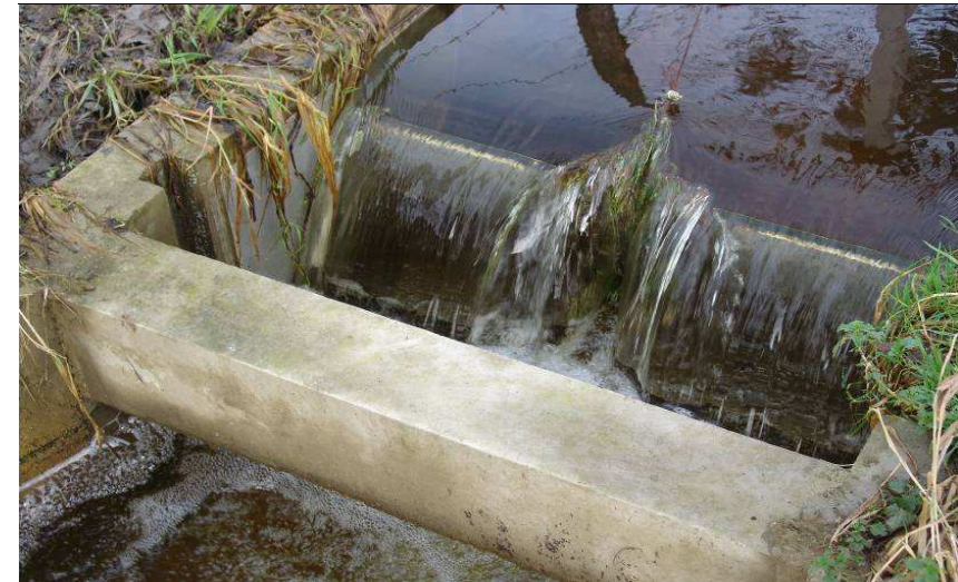
Dispositif du contrôle des niveaux d'eau
