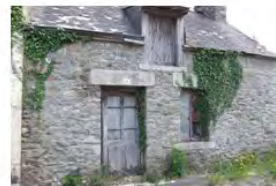
Bâti à l'abandon
