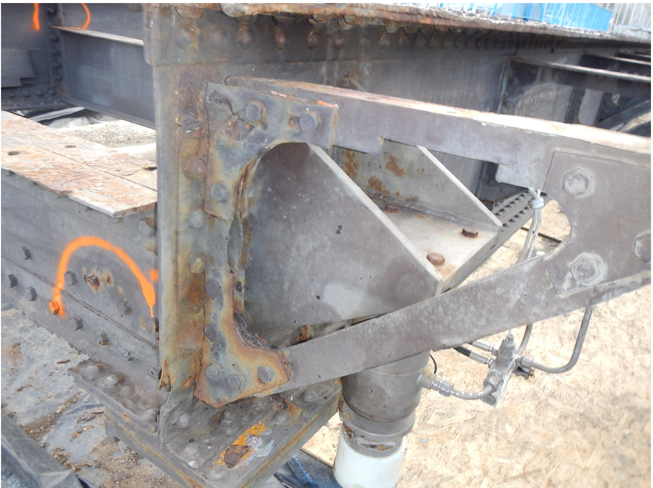
- corrosion du tablier métallique -
