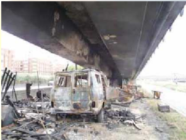
État douteux suite à un incendie
