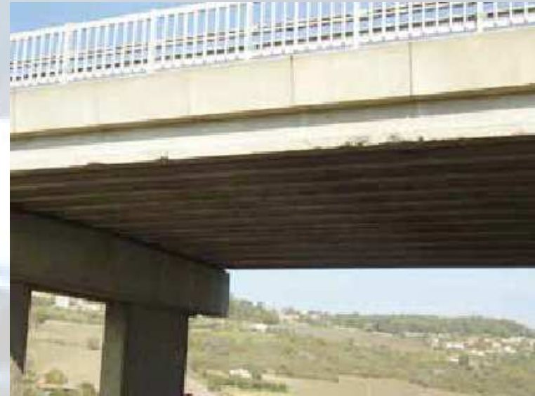
État douteux suite à un choc
