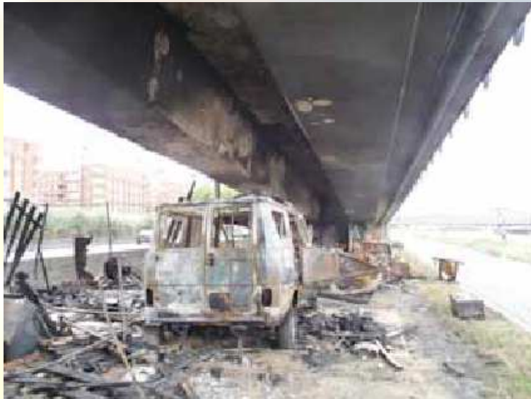
État douteux suite à un incendie
