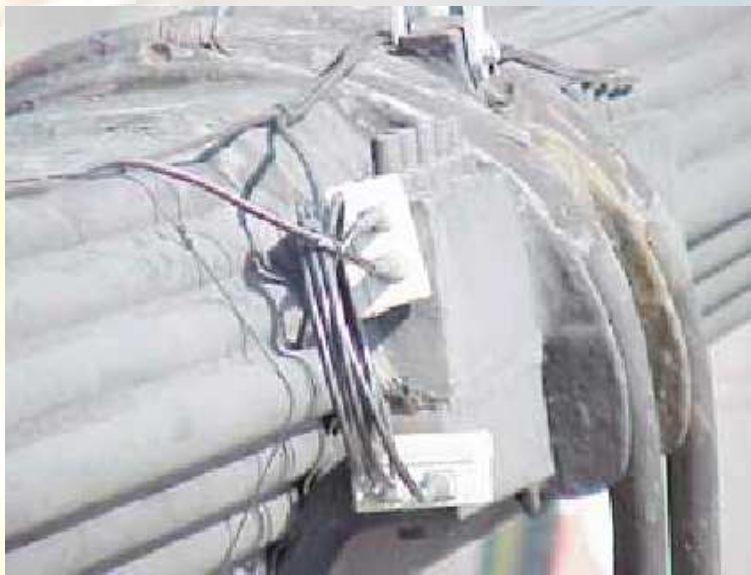
Instrumentation d'un collier d'un câble
