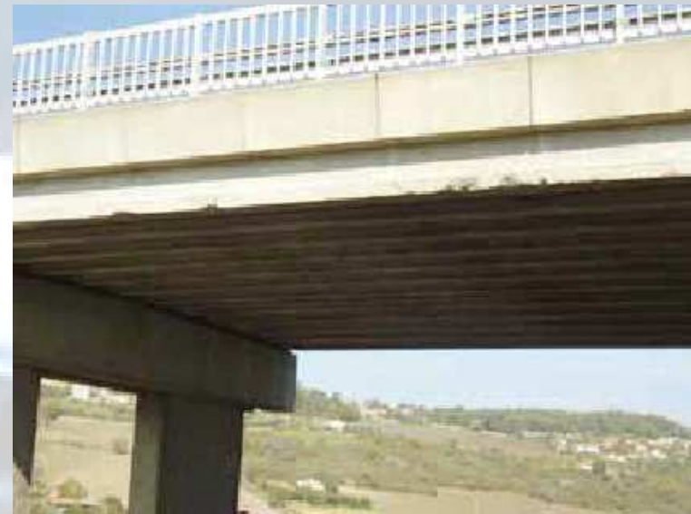
État douteux suite à un choc
