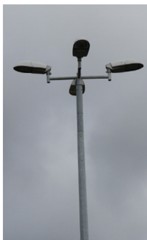
Éclairage par luminaires horizontaux (Port ouest)
