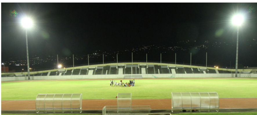
Éclairage du stade de Saint-Paul (mode réduit pour l'entraînement)
