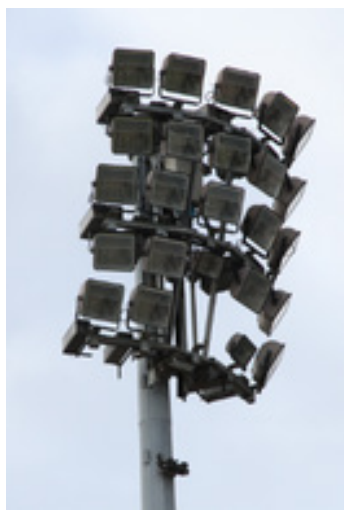
Batterie de projecteurs du stade de Saint-Paul
