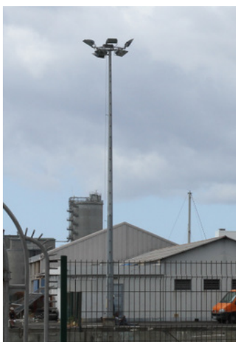
Éclairage par projecteurs sur couronne (Port ouest)
