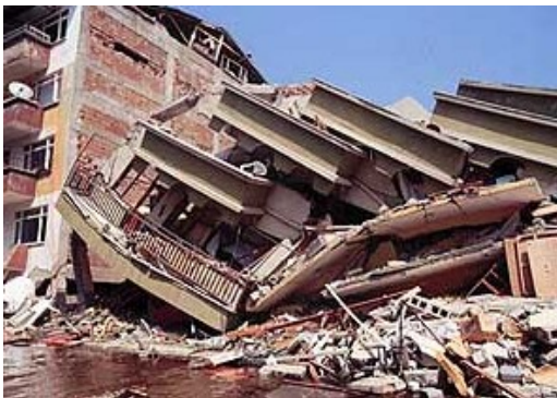
Effondrement d'un centre commercial (Izmit, 1999)
