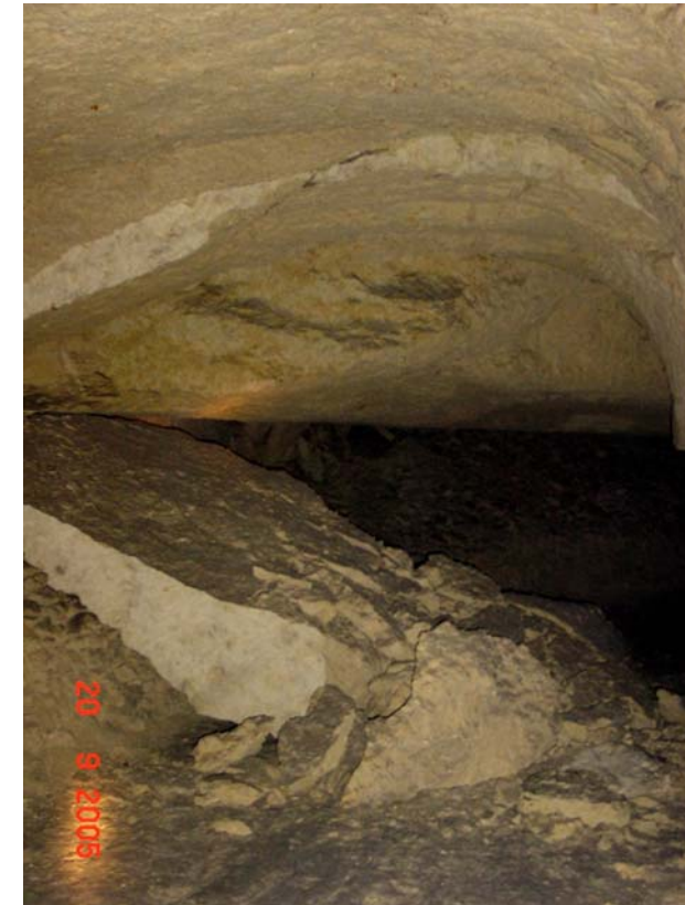
Photo 2 : Rupture d'un banc du toit d'une carrière souterraine à Dampierre-sur-Loire
