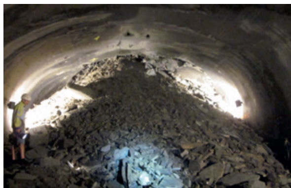
La voûte effondrée du tunnel en juillet 2015
