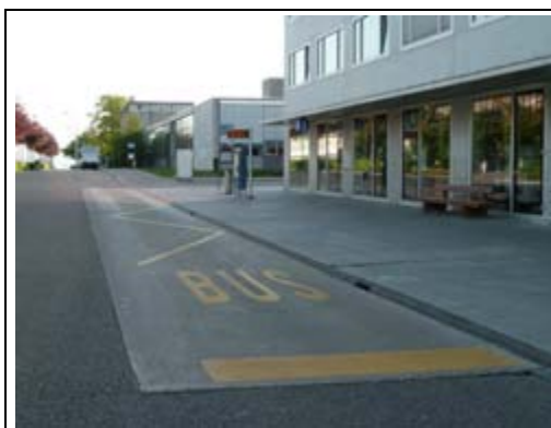
Zurich, presque toutes les stations sont en béton (BCMC)
