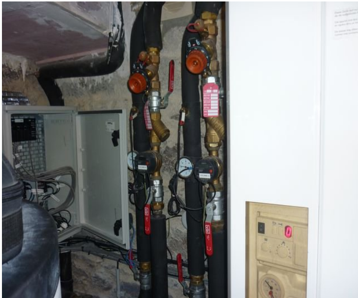
Chaudière Gaz à condensation Radiateurs et robinets thermostatiques.
