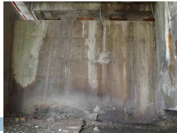
About d'ouvrage – Défauts d'enrobage et d'étanchéité des joints – Photos CD54
