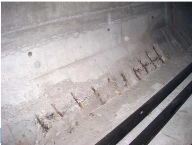
Intérieur d'un caisson en BP de 1976 – Défauts d'enrobage – Photos CD54
