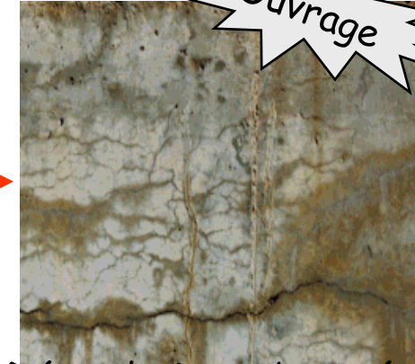
Dégradations observées (barrages, ponts, routes)
