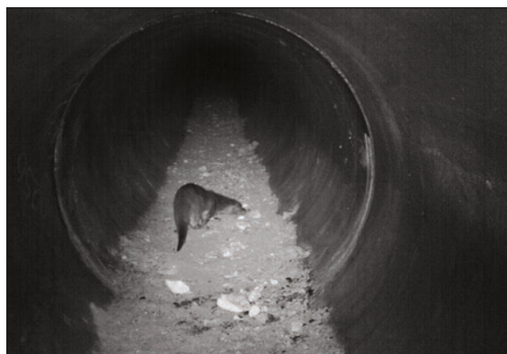
Photo n°14 : Loutre « Marguerite » dans un écoduc de 120 cm. (© LPO France, VINCI Autoroutes).
