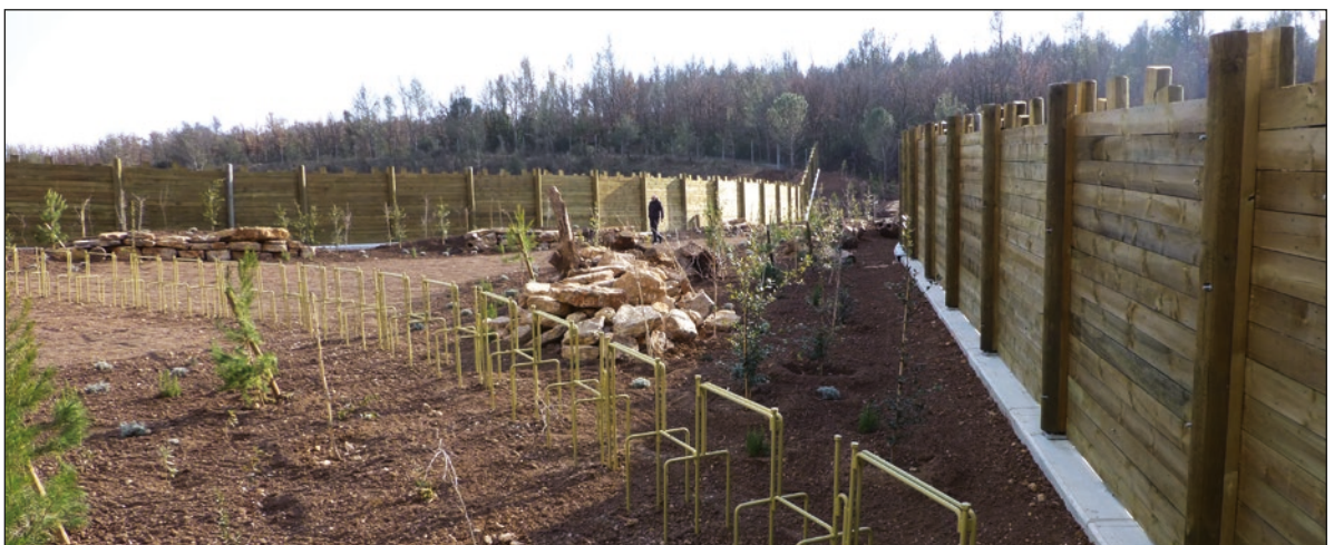
Photo n°40 : Barrière métallique anti intrusion engin, mais perméable à la faune, sur un écopont. (© VINCI Autoroutes).
