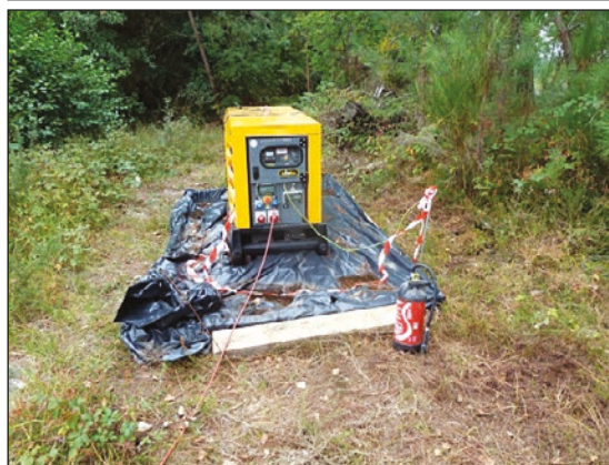
Photos n°47 : Kit anti-pollution, groupe électrogène sur cuve double fond avec bâche imperméable tout autour (de haut en bas). (© VINCI Autoroutes).
