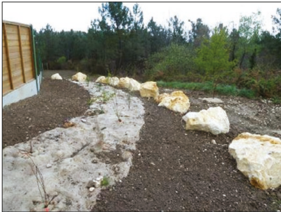
Photo n°39 : Alignement de blocs anti-intrusion. (© VINCI Autoroutes).
