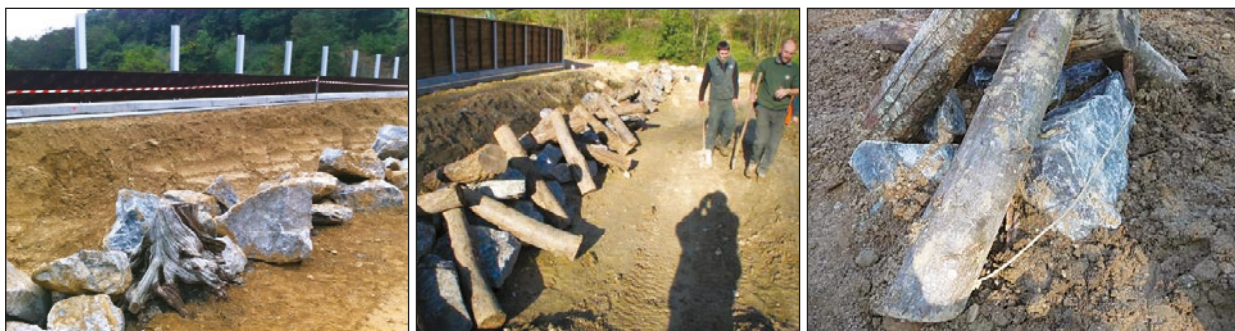
Photos n°38 : Réalisation d'andains ; on note le passage du câble sur la photo de droite (de gauche à droite). (© VINCI Autoroutes).
