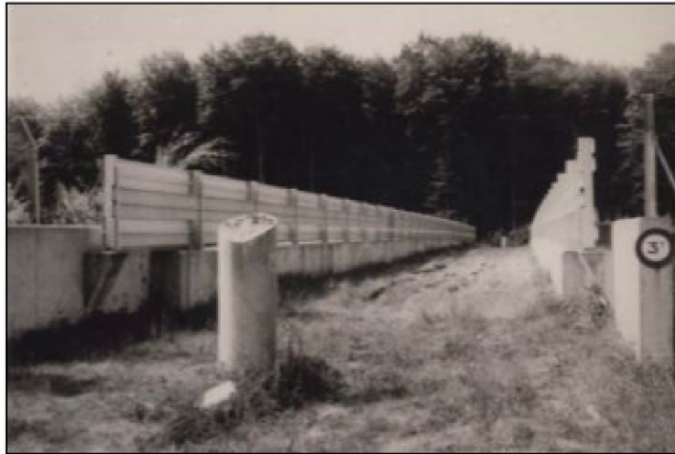
Photo 20 : Autoroute A13, Forêt de Bord (Eure) Passage supérieur largeur 4m50 Source : Note d'information "Protection de la faune et de la circulation routière" Setra [5]
